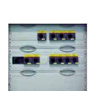
щит распределительный с АВР (автоматический ввод резерва)
